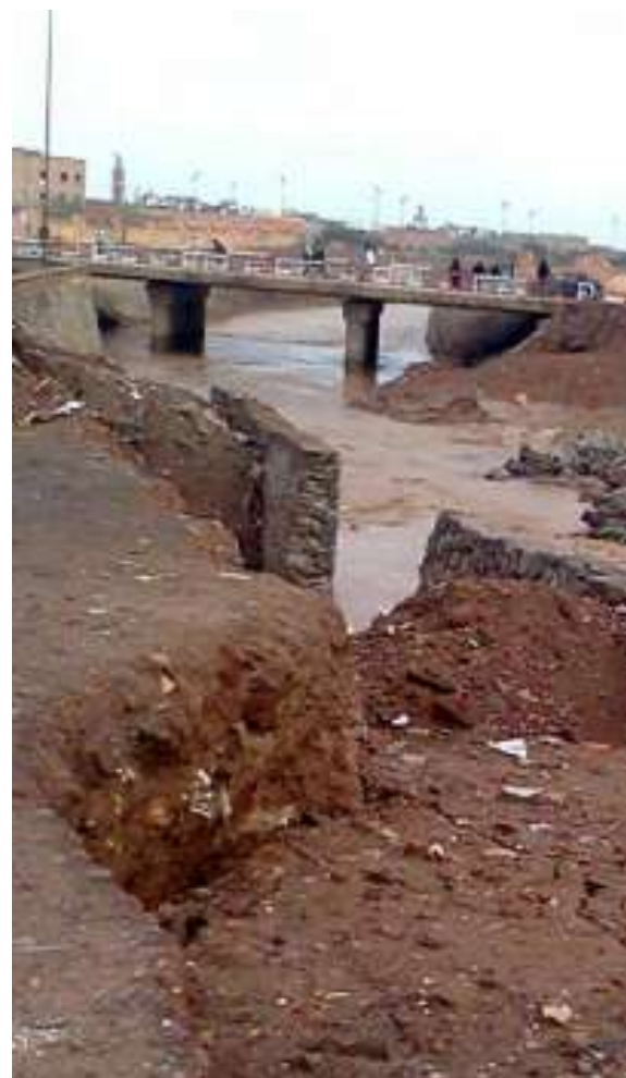
Dégradation d'une berge de la rive gauche d'Issil et endommagement du mur de protection. (El Mehdi Saidi et al, 2013).
